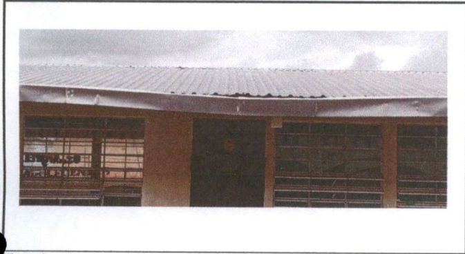
Foto: Canal a reparar
