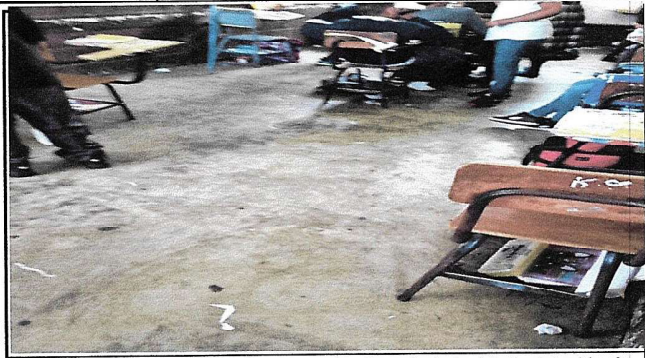
Foto 2: Área de salón 2 de clases, en donde se trabajará la instalación de piso.
