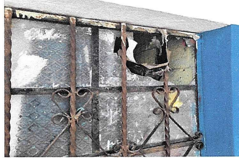
Foto 2: Área de ventana con vidrio roto para cambio.
