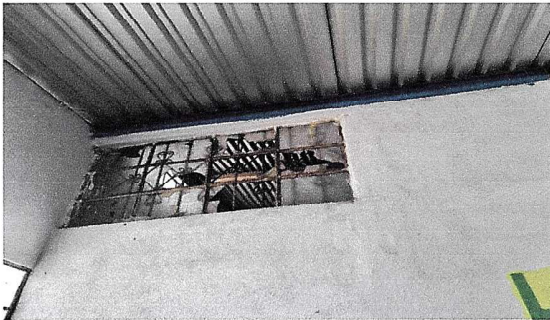
Foto 3: Área de vidrios quebrados dentro de un salón de clases.
