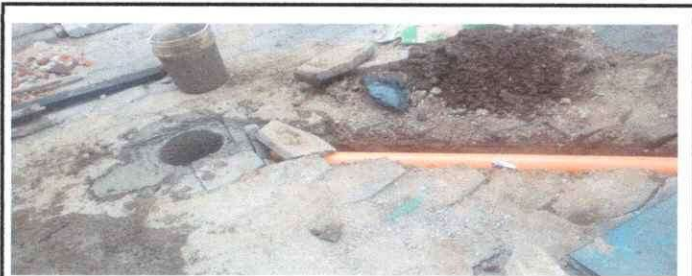
Foto 5: drenaje de pila
