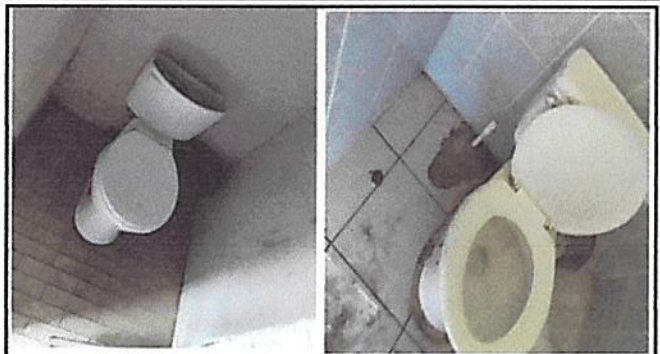
Foto 2: Sanitarios y accesorios
