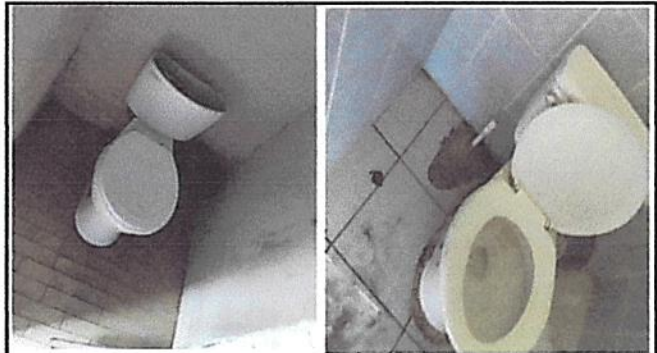
Foto 2: Sanitarios y accesorios
