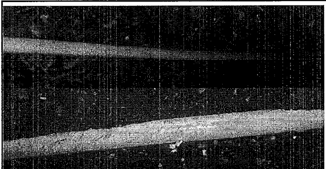
Sustitución de tubería PVC línea principal aguas negras: Presenta algunas roturas y fisuras lo que provocaba en algunos casos fugas y filtraciones de aguas negras, la tubería muestra signos de desgaste y corrosión.
