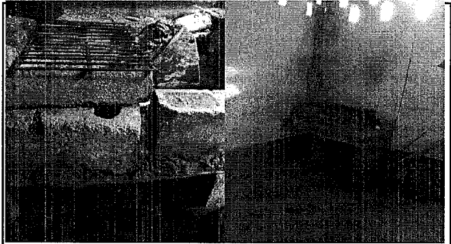
Sustitución de chimenea de metal y de estufa rural: La chimenea de metal muestra signos de desgaste, se cuenta con un polletón pero carece de algunos componentes esenciales como una plancha y una parrilla adecuada.
