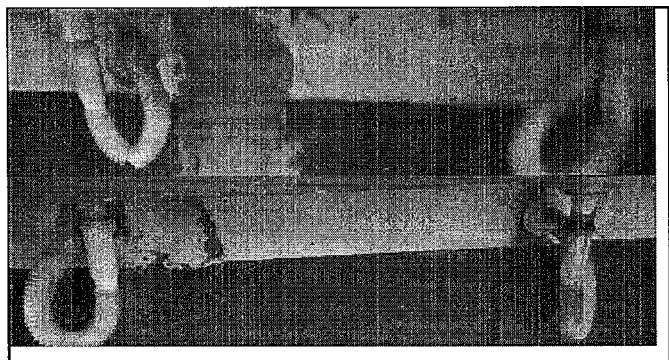
Sustitución de lavamanos: Sifones en mal estado y rotos, lo que provocaba que el agua se saliera al lavarse las manos y presentaban algunas rajaduras en el lavamanos que causaban filtración de agua, mojando la pared y el piso.
