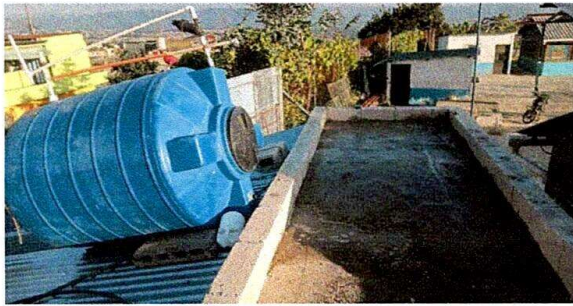
Foto 3: SE ESTA REALIZANDO EL DESNIVEL DE AGUA EN LA TERRAZA DE LOS SANITARIOS DE LA J.M.
