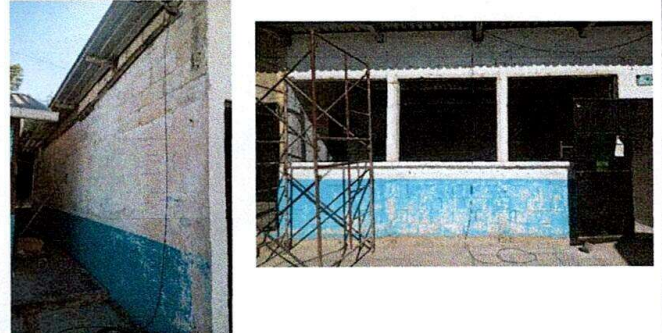
Foto 2: SE REPELLARA EL AREA DE ENFRENTA DE LOS DOS SALONES Y EL LADO POSTERIOR DEL SALON DE PRIMERO PRIMARIA
