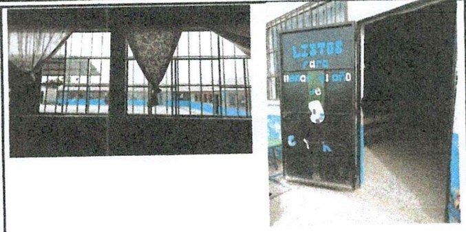
Foto: 2 SALÓN 1RO. PRIMARIA J.M. CAMBIO DE 3 VENTANAS DE PVC, INSTALACIÓN DE PUERTA DE METAL NY BARANDAL DE METAL, Y MANTENIMIENTO DE DE 3 BALCONES .
