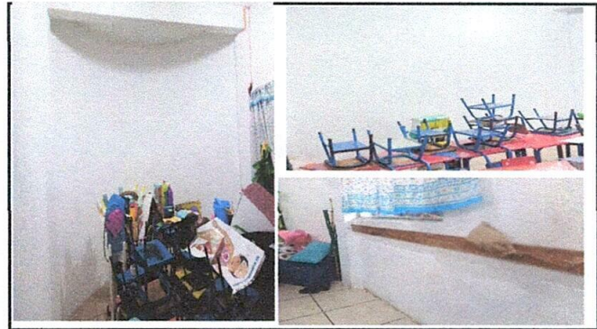
Foto 4: aula kinder, repello por filtracion módulo 1 y cambio de chapa aula de segundo módulo 2
