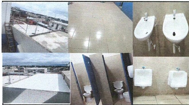
Foto1: FILTRACION EN LOSA de terraza , colocacion de malla modulo 1 cambio de pisos dañados módulo 1, cambio de lavamanos, sanitarios y orinales
