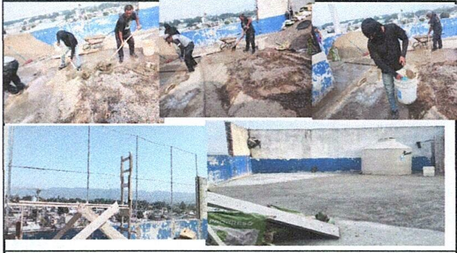
Foto 2: LOSA CON PROBLEMAS DE FILTRACION módulo 2
