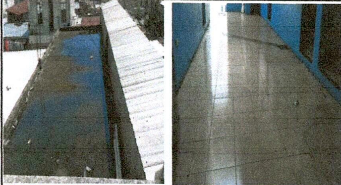
Foto: FILTRACION EN LOSA de terraza y cambio de pisos dañados módulo 1
