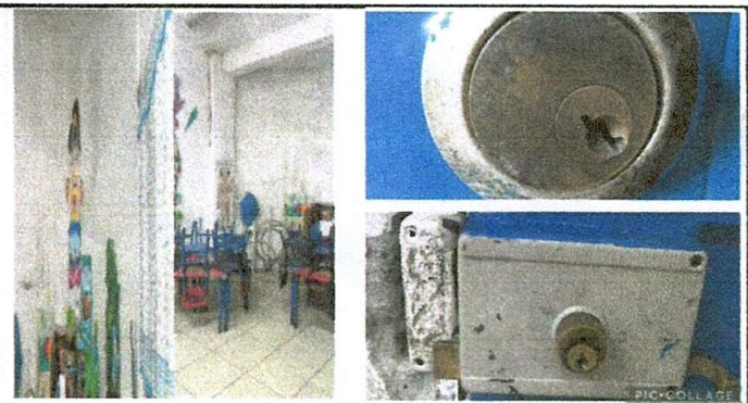
Foto: 4 aula kinder, repello por filtracion módulo 1 y cambio de chapa aula de segundo módulo 2
