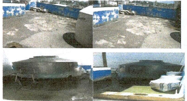
Foto: 2 LOSA CON PROBLEMAS DE FILTRACION módulo 2
