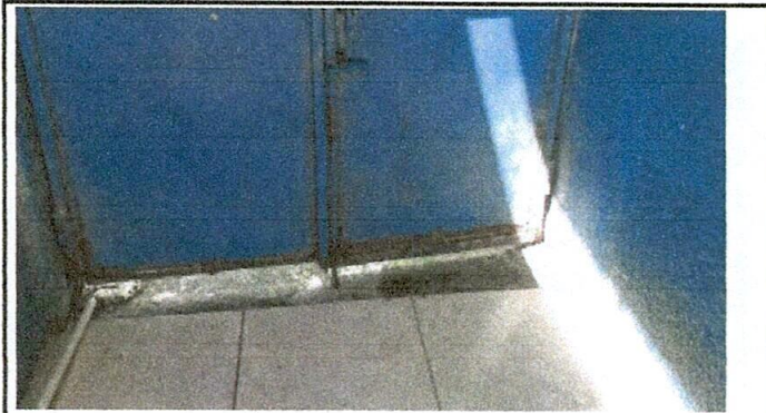
Foto: 3 reparació de puerta y cambio de chapa salida de emergencia módulo 2
