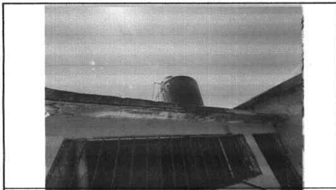
Foto 5: Tinaco en malas condiciones es necesario sustituirlo
