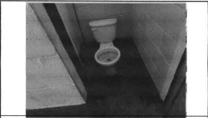
Foto 5: Modulo de Baños, sanitarios en mal estado
