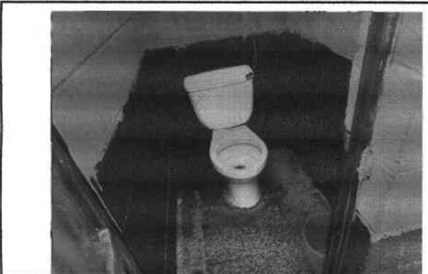
Foto 4: Modulo de Baños, sanitarios en mal estado
