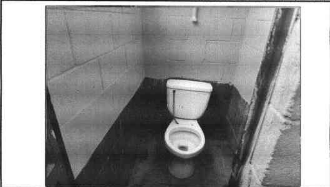
Foto 3: Modulo de Baños, sanitarios en mal estado
