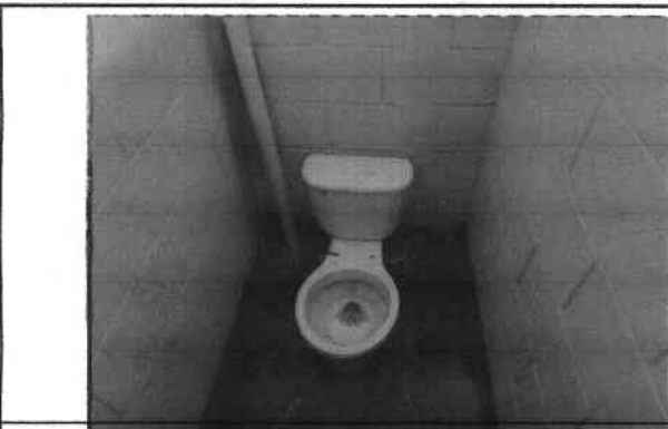
Foto 6: Modulo de Baños, sanitarios en mal estado
