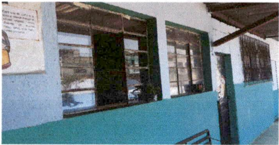
FOTO 9: se pondrán balcones en ventanas que no poseen.
