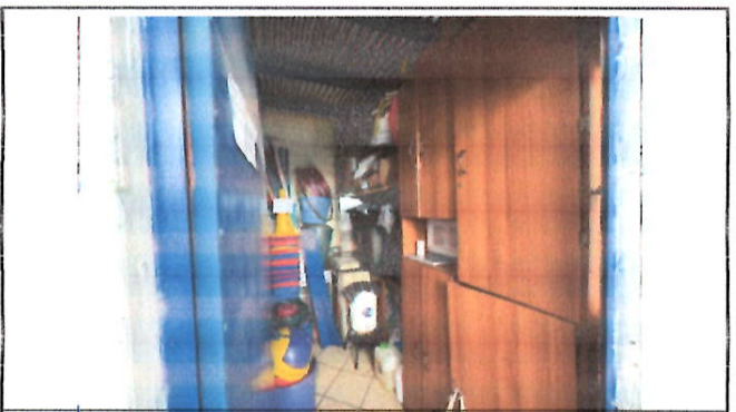
Foto 12: Es necesario colocar campana en cocina, así como muebles fijos de concreto con azulejo
