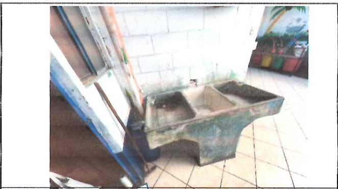
Foto 11: Pila en mal estado, es necesario sustituirla
