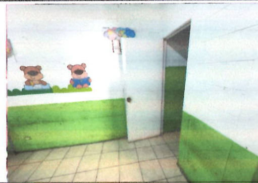
Foto 6: Puertas en mal estado, necesitan cambio
