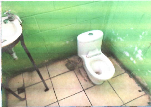
Foto 3: Sanitarios en mal estado, así mismo lavamanos dañados, también es necesario colocar azulejo
