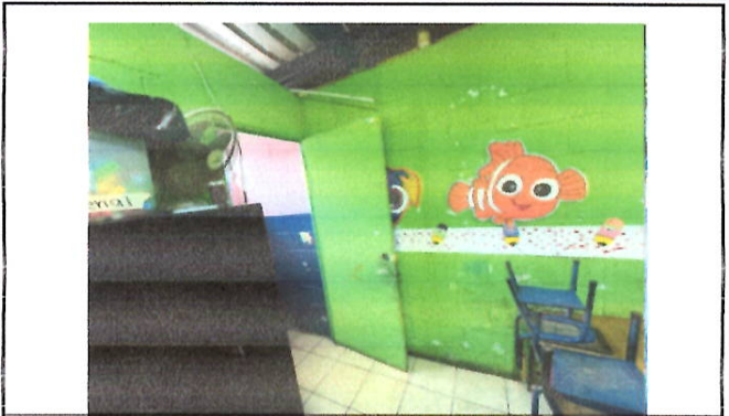
Foto 8: Puertas en mal estado, necesitan cambio, así mismo se observa que los muros necesitan aplicación de pintura
