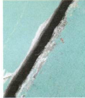
Foto 2: Separacion de pared con daños
