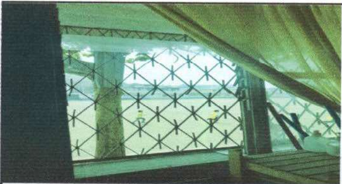
Foto 10. LAS VENTANAS YA NO CUENTAN CON VIDRIOS
