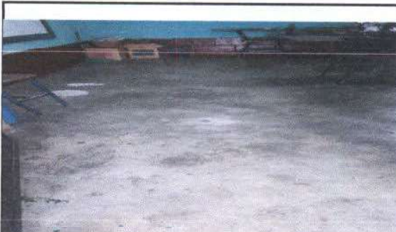
Foto 4.: Piso en aulas
