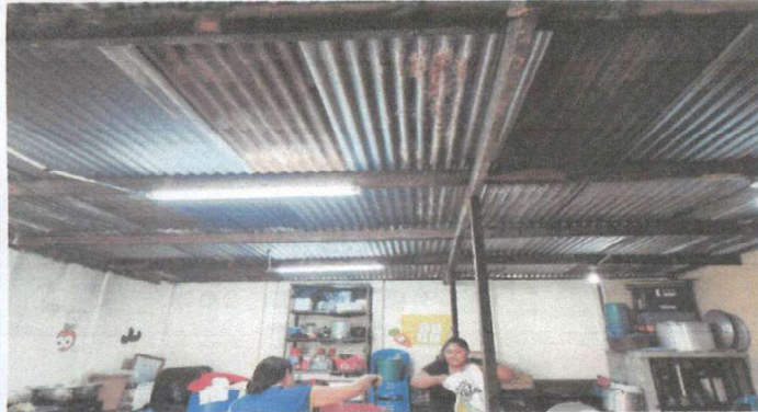
Foto: 1 El techo de la cocina se encuentra en mal estado , los tendales estan quebrados y los parales ya se undieron en el suelo
