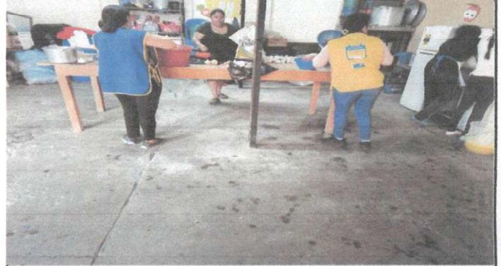
Foto: 2 El piso de la cocina se encuentra corcomido, agrietado
