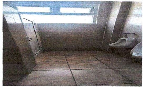
Foto 2: Sanitarios que requiere de nueva conexión
