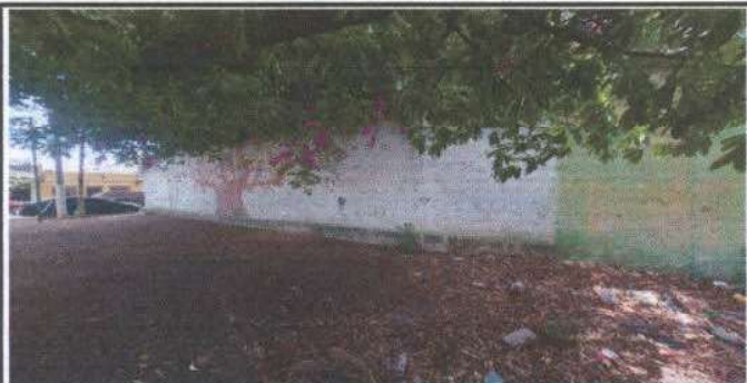
Foto 7: PARED A REMOZAR PARTE EXTERIOR
