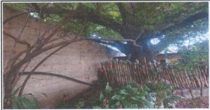
Foto 4: LEVE INCLINACION PARA AFUERA
