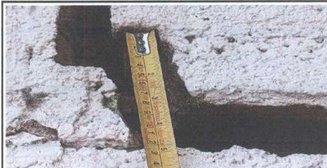
Foto 8.: MEDIDA DE LAS GRIETAS A REMOZAR
