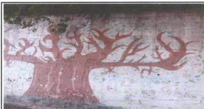
Foto 10.: GRIETA EN LA PARTE DE AFUERA
