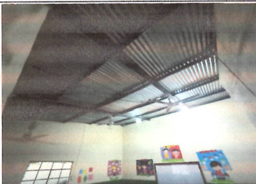
Foto 5: Modulo 1 lamina y sistema electrico en malas condiciones
