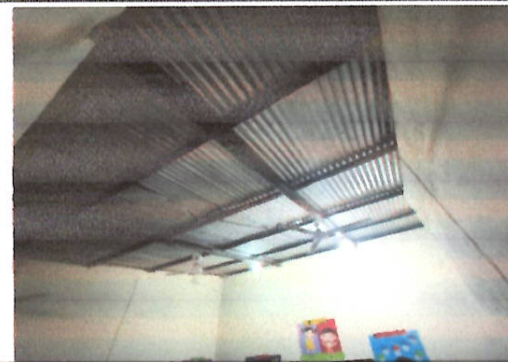
Foto 6: Modulo 1 lamina y sistema electrico en malas condiciones
