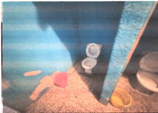
Foto 4: Sanitarios en mal estado y sin puertas
