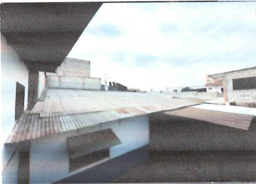
Foto 9: Modulo 1 lamina y sistema electrico en malas condiciones
