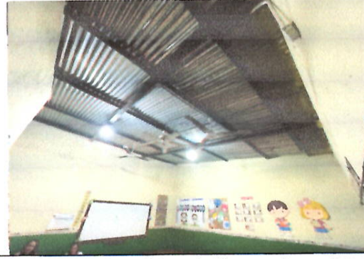
Foto 8: Modulo 1 lamina y sistema electrico en malas condiciones
