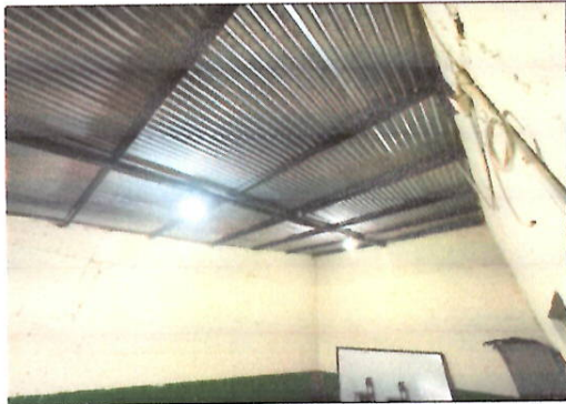
Foto 7: Modulo 1 lamina y sistema electrico en malas condiciones
