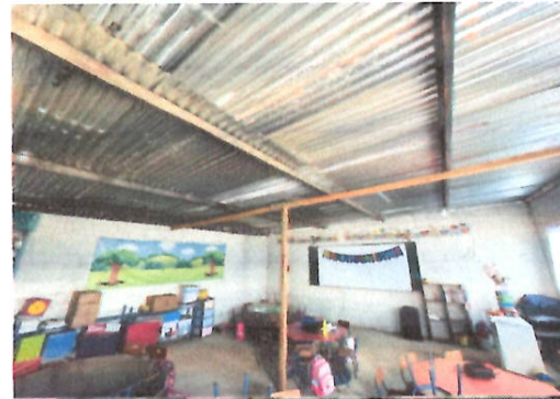
Foto 10: Modulo 2, se observa el mal estado de la estructura de soporte y cubierta de lamina
