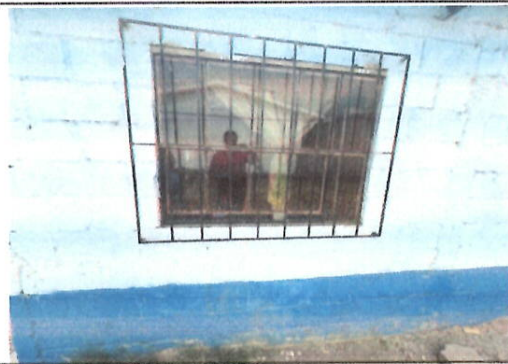
Foto 12: Modulo 2, es necesario sustituir ventanas por ventanas tipo PVC
