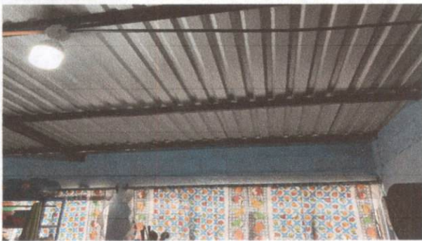
Foto 5: LÁMINA DE COCINA
