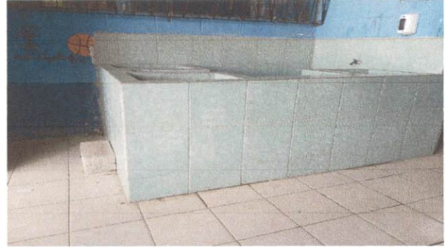
Foto 2: PILETA DE 3 LAVADEROS
