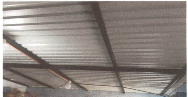
Foto 6: LÁMINA DE COCINA
