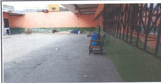
Foto 5.: Piso en corredor
