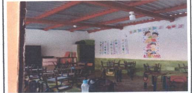
Foto 4.: Piso en aulas
