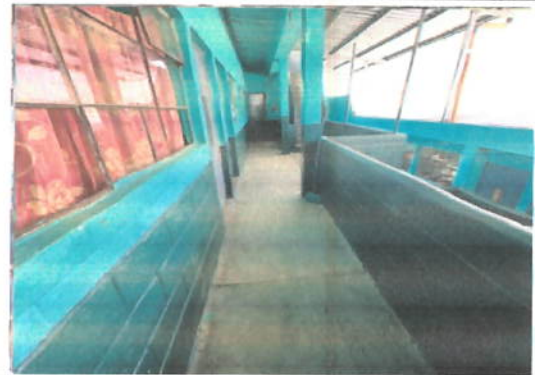
Foto 8: Pasillo 1, es necesario colocar piso ceramiro
