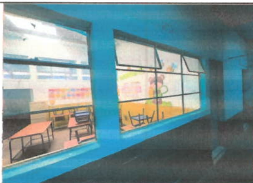
Foto 11: Es necesario colocar ventanas tipo PVC
