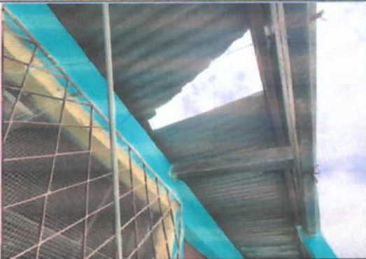
Foto 5: Modulo 1, Lamina en mal estado es necesario sustituirla
