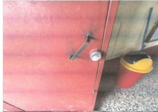
Foto 10: Modulo general Chapas en mal estado
