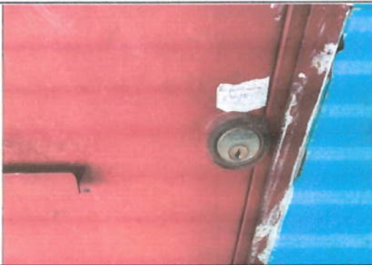
Foto 11: Modulo general Chapas en mal estado
