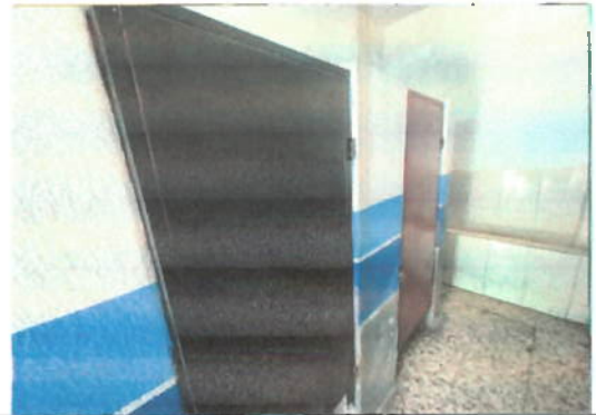
Foto 4: Modulo de Baños, puertas necesitan mantenimiento
