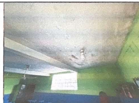
Foto 12: Modulo 2, es necesario impermeabilizar losa para evitar humedad
