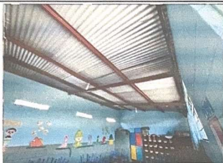
Foto 7: Modulo 1, es necesario sustituir cubierta de lamina que se encuentra deteriorada
