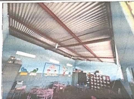
Foto 8: Modulo 1, es necesario sustituir cubierta de lamina que se encuentra deteriorada
