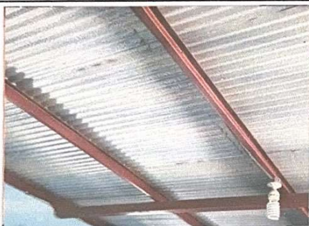
Foto 9: Modulo 1, es necesario sustituir cubierta de lamina que se encuentra deteriorada
