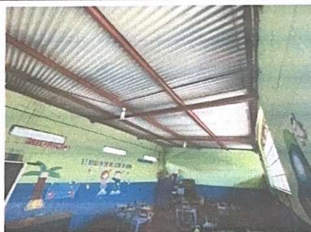
Foto 10: Modulo 1, es necesario sustituir cubierta de lamina que se encuentra deteriorada
