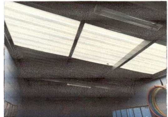
Foto 10: Modulo 3, se debe sustituir lamina que se encuentra en mal estado
