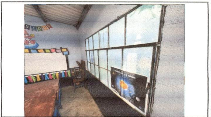
Foto 6: Modulo 3, Es necesario colocar piso ceramico
