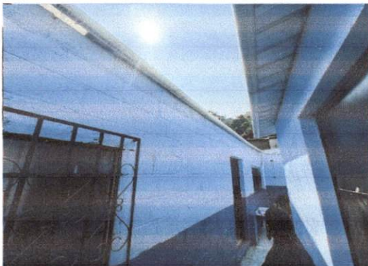
Foto 9: Modulo 2 (Cocina) y modulo 3, se sustituirán canales por canal calibre 26, así mismo aplicar pintura en muros
