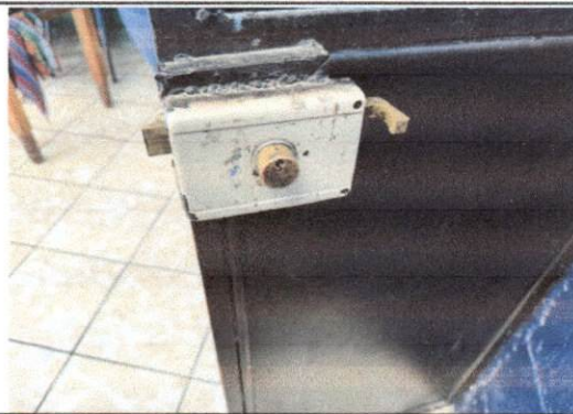
Foto 11: Se deben sustituir chapas y dar mantenimiento a puertas
