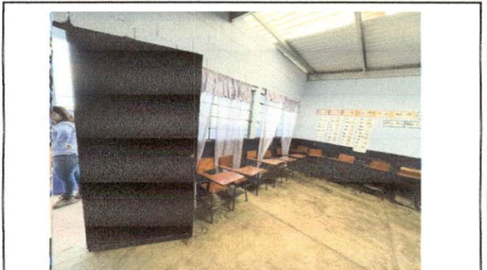
Foto 4: Modulo 1, Es necesario darle mantenimiento a puerta ✓
