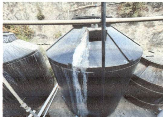
Foto 4: Se debe sustituir tinacos en mal estado
