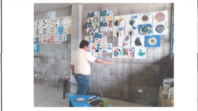
Foto 8: Humedad en muros de aulas
