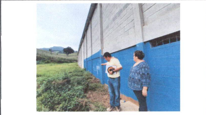
Foto 9: Falta protección lateral en parte exterior
