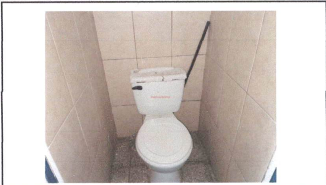
Foto 2: Sanitarios quebrados sin uso
