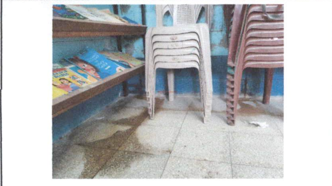
Foto 7: Filtración de agua en aula
