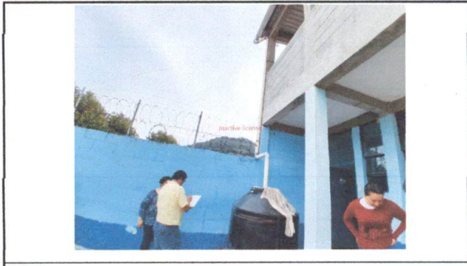
Foto 6: Tinaco actual en mal estado
