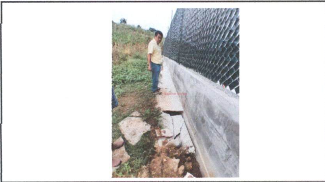
Foto 11: Canal posterior dañada
