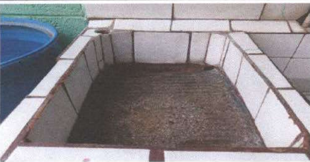
Foto.: Pila con deterioro
