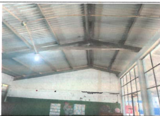
Foto 12: Modulo 3, se observa el mal estado de la lamina
