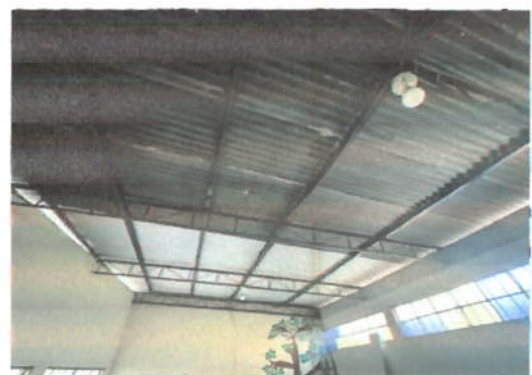
Foto 4: Modulo 1, se observa el mal estado de la lamina
