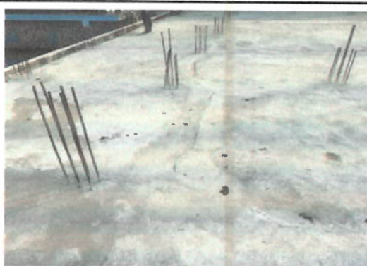
Foto 8: Modulo 2, se observan grietas en la losa es necesario impermeabilizar
