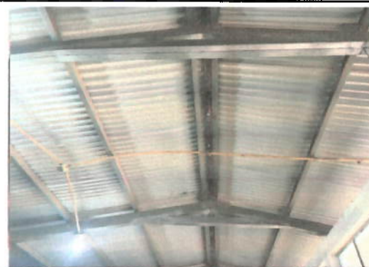
Foto 10: Modulo 3, se observa el mal estado de la lamina
