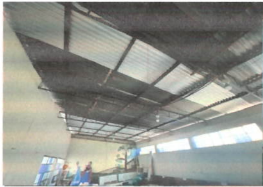
Foto 3: Modulo 1, se observa el mal estado de la lamina
