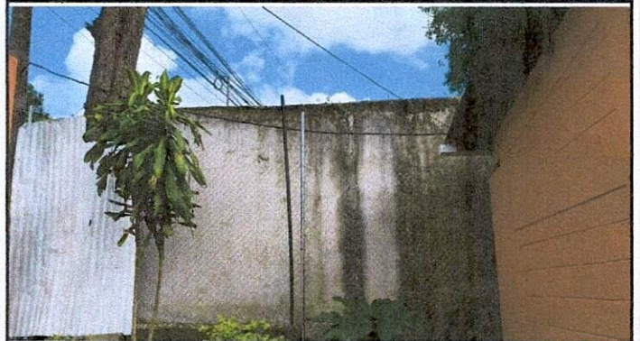
Foto 4: Pintura, malla lateral derecho escuela.
