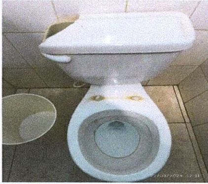
Foto 1: Sanitario a cambiar de baño de niñas
