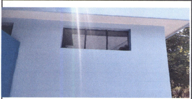
Foto 5: VENTANAS EN MAL ESTADO, LAS CUALES SE SUSTIURAN EN SU TOTALIDAD.
