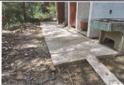
FOTO 3: TORTA DE CONCRETO EN ÁREA DE SERVICIOS SANITARIOS
