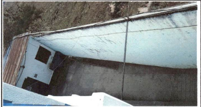
Foto 2: Area del espacio que se necesita ser techado para proporcionar seguridad a la comunidad Educativa.
