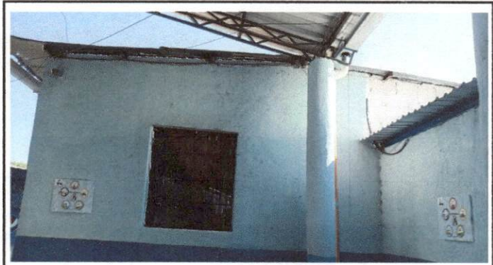
Foto 4: Segundo espacio a trabajar en donde se cambiará el techo, como se visualiza en la esquina superior izquierda la lámina se encuentra deteriorada.
