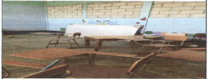
FOTO 2 PINTURA EN LAS PAREDES DEL ESTABLECIMIENTO DEBIDO A QUE HACE MUCHO TIEMPO QUE NO SE HA PINTADO LAS PAREDES Y ALGUNAS PARTES SE ENCUNTRAN SIN
