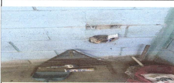
FOTO 3. ES NECESARIO LA INSTALACION DE LAVAMANOS PARA BRINDAR UN MEJOR SERVICIO A LOS ALUMNOS. LAS MISMAS NO HAY EN LA ESCUELA
