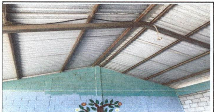
FOTO 6: SE CAMBIARA EL CABLEADO ELECTRICO, YA QUE EN LA ACTUALIDAD NO SE CUENTA CON ENERGIA ELECTRICA EN EL ESTABLECIMIENTO.
