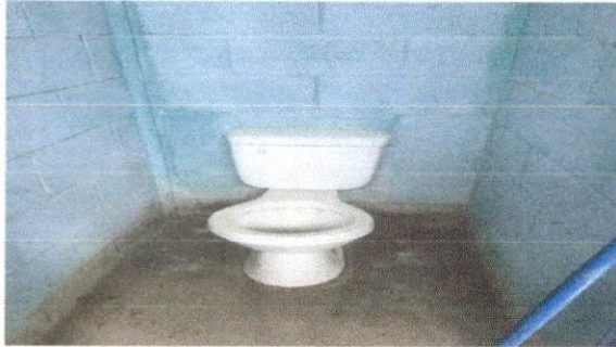
FOTO 1. REMODELACION DE SANITARIO YA QUE LAS QUE SE ENCUENTRAN ACTUALMENTE SE ENCUENTRAN DETERIORADAS
