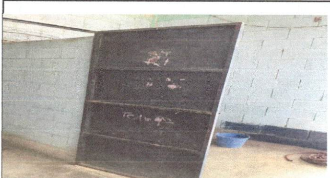
FOTO: 4 LA PUERTA DE LOS BAÑOS TAMBIEN SE ENCUENTRAN EN MUY MAL ESTADO, SE PINTARAN LAS PUESTAS.
