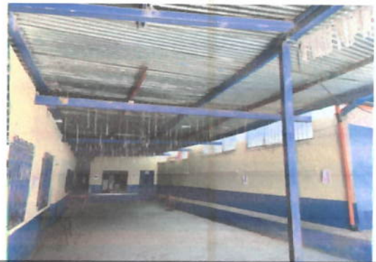
Foto 8: Modulo 2, se observa el mal estado de la cubierta de Techo
