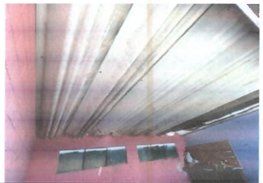
Foto 4: Modulo 1, se observa que se cuenta con lamina de Fibrocemento, es necesario sustituirla y colocarle estructura portante
