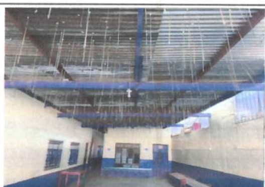
Foto 12: Modulo 2, se observa el mal estado de la lamina
