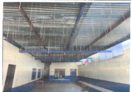
Foto 10: Modulo 2, se observa el mal estado de la lamina
