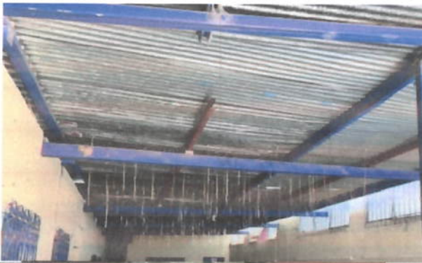
Foto 9: Modulo 2, otra vista del estado de la lamina
