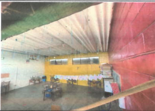
Foto 5: Modulo 1, se observa que se cuenta con lamina de Fibrocemento, es necesario sustituirla y colocarle estructura portante y colocar lamparas tipo LED y sistema electrico
