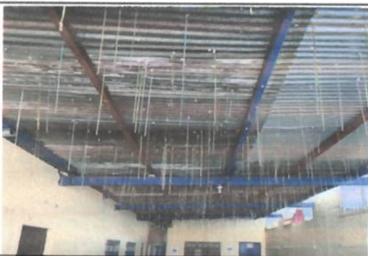
Foto 11: Modulo 2, se observa el mal estado de la lamina
