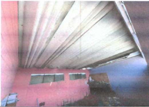
Foto 3: Modulo 1, se observa que se cuenta con lamina de Fibrocemento, es necesario sustituirla y colocarle estructura portante
