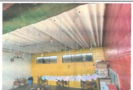
Foto 6: Modulo 1, se observa que se cuenta con lamina de Fibrocemento, es necesario sustituirla y colocarle estructura portante y colocar lamparas tipo LED y sistema electrico
