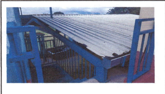
Foto 4: SE NECESITA REALIZAR LA DISTRIBUCION DEL SISTEMA DE AGUA POTABLE PARA LA BATERIA DE SERVICIOS SANITARIOS
