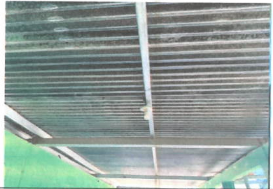
Foto 8: Modulo 3, Lamina en mal estado, es necesario sustituirla
