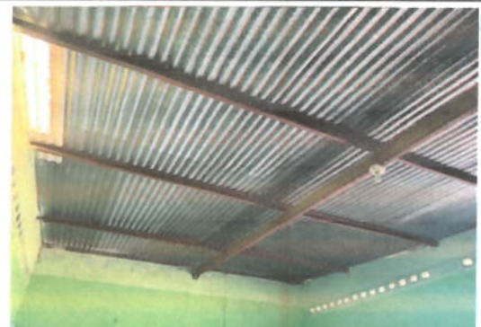
Foto 6: Modulo 2, Lamina en mal estado, es necesario sustituirla
