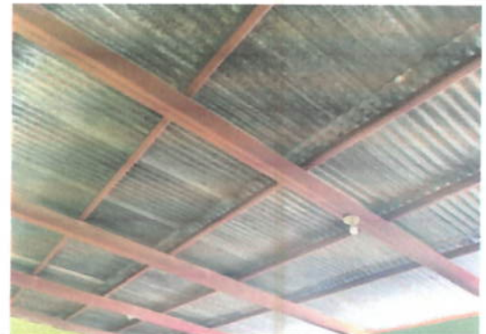
Foto 4: Modulo 1, Lamina en Mal estado, es necesario sustituirla
