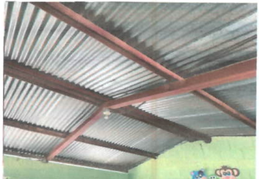
Foto 10: Modulo 4, lamina en mal estado, es necesario sustituirla
