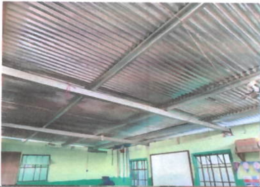
Foto 9: Modulo 3, Lamina en mal estado, es necesario sustituirla
