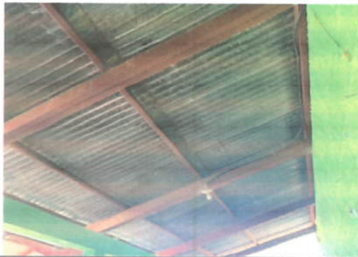
Foto 3: Modulo 1, Lamina en Mal estado, es necesario sustituirla
