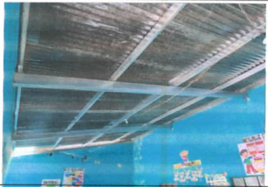
Foto 12: Modulo General, es necesario aplicar pintura en muros
