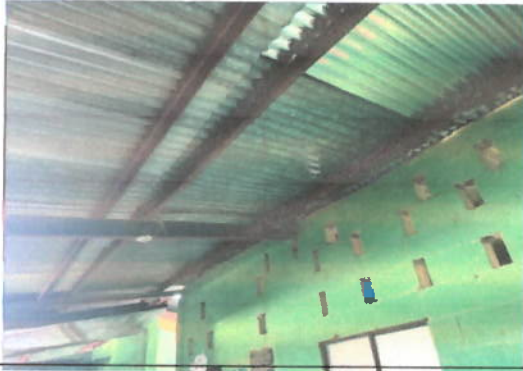
Foto 7: Modulo 2, Lamina en mal estado, es necesario sustituirla
