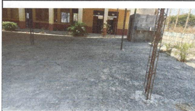
Foto 2: LOSA DE PATIO DE CEMENTO CON DESNIVEL
