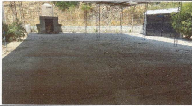
Foto 1: LOSA PATIO EN MAL ESTADO
