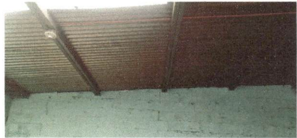
Foto 2: MÓDULO No. 1 SE NECESITA EL DESMONTAJE, PINTURA Y MONTAJE DE LA ESTRUCTURA METÁLICA EXISTENTE
