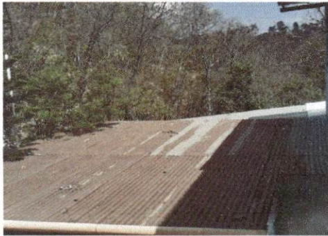
Foto 3: MÓDULO No. 1 SE NECESITA EL CAMBIO DE LÁMINA, YA QUE SE ENCUENTRA DETERIORADA
