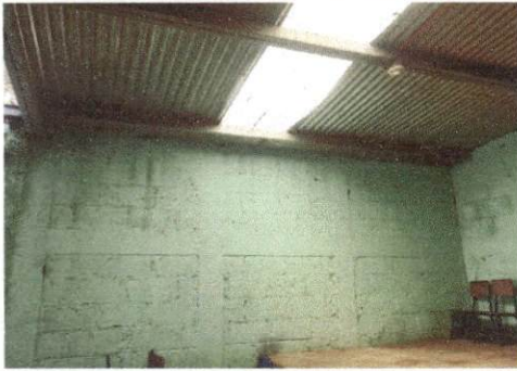
Foto 1: MÓDULO No. 1 PATIO SE NECESITA EL LEVANTADO DE MURO PARA LA CAIDA DE AGUA PLUVIAL DEL TECHO
