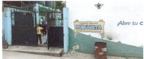
Foto 4: MÓDULO No. 1 SE NECESITA EL MANTENIMIENTO DEL PORTON DE INGRESO A LA ESCUELA YA QUE SE ENCUENTRA EN MALAS CONDICIONES
