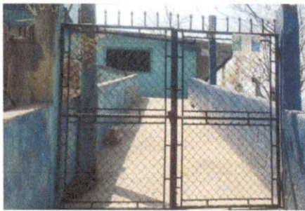
Foto 5: MÓDULO No. 3 INGRESO Y PATIO, PORTÓN, DEBIDO A LA FALTA DE SEGURIDAD EN LA ESCUELA ES NECESARIO EL CAMBIO DE PORTÓN
