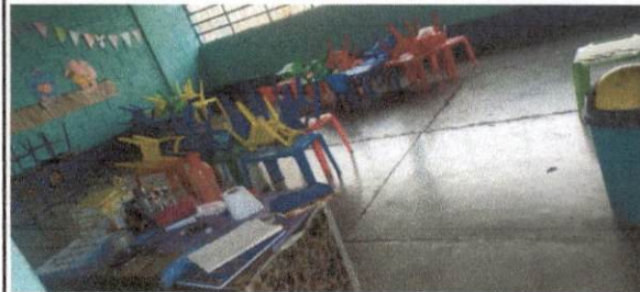
Foto 2: MÓDULO No. 1 AULAS, LOSA DE CONCRETO ACTUAL RAJADA Y DESNIVELADA, NECESITA NIVELACIÓN
