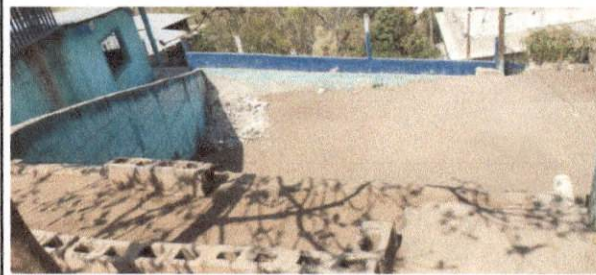
Foto 4: MÓDULO No. 3 INGRESO Y PATIO, BARANDAL LOS NIÑOS JUEGAN EN ESTA ÁREA Y CORREN EL RIESGO DE CAER POR LO QUE SE NECESITA UN BARANDAL PARA LA PROTECCIÓN
