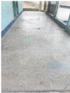
Foto 3: MÓDULO No.2 AULAS, PASILLO LOSA DE CONCRETO ACTUAL RAJADA Y DESNIVELADA, NECESITA NIVELACIÓN, LOS NIÑOS SE TROPIEZAN, RAZÓN POR LA CUAL ES NECESARIO LA COLOCACIÓN DE BARANDAL
