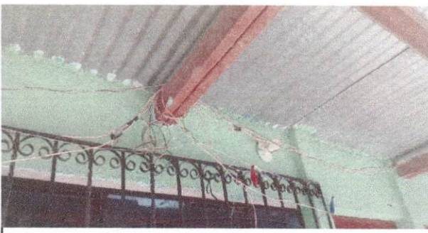
Foto 6: Es necesario reparar tendido eléctrico ya que los cables están sueltos, colocar accesorios en la cocina para aparatos eléctricos y otros.
