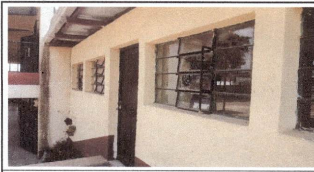
Foto 5: Falta de canaleta.
