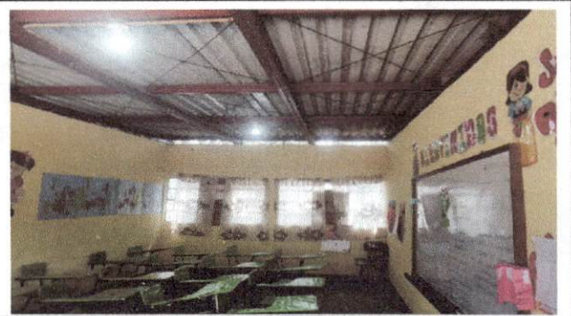
Foto 2: Techo con las laminas deterioradas
