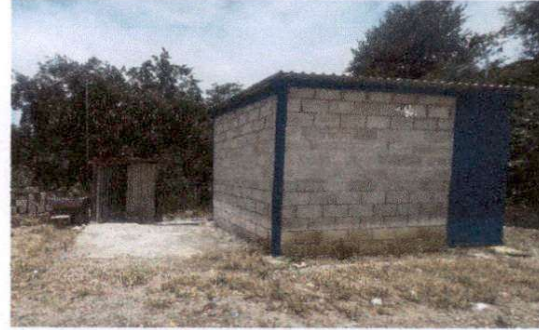
Foto 8: Cernido en paredes exteriores de cocina.
