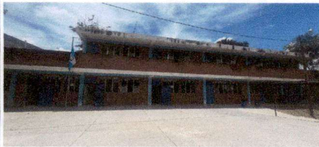
Foto 1: El establecimiento necesita pintura en el exterior de las instalaciones.
