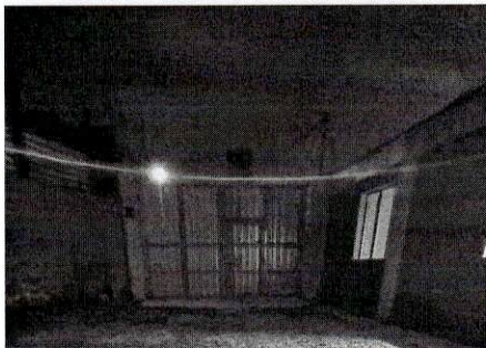
Foto 5: Módulo No. 1 El portón de ingreso a la escuela necesita mantenimiento
