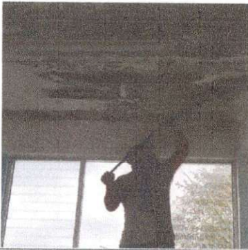
Foto 3: Proceso de limpieza del lado interno dañado salón 2 y bodega de la losa a Remosar
