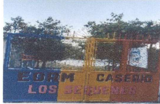
Foto 2: Necesidad de colocación de Techo de dos aguas a portón principal
