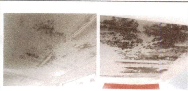
Foto 3: Lado interno dañado salón 2 y bodega de la losa a Remosar
